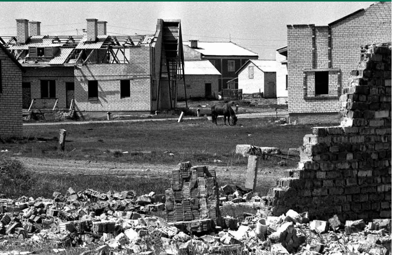
Diese Häuser in der Stadt Dribin waren ursprünglich für Umsiedler aus den verstrahlten Regionen geplant. Der Bau wurde wegen Geldmangel gestoppt. Nun werden die Baumaterialien nach und nach von Anwohnern »wiederverwert« (Aufnahme vom 15. Mai 1996). Foto: V. Mežević/Belarussisches staatliches Archiv für Film-, Bild und Tondokumente (BGAKFFD)
