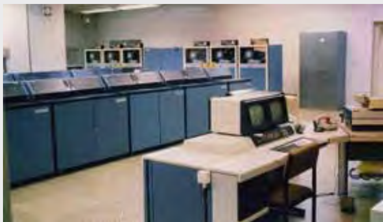
Blick in das mit ESER-Technik ausgestattete zentrale MfS-Rechenzentrum (Abteilung XIII) in den 1980er Jahren. Vorne ein Kontrollmonitor, in der linken Bildmitte eine Reihe von 200 MB-Wechselplattenspeichern (EC 5067) (Foto: BStU, MfS, Abt. XIII, Fo 0002, Bild 0002).
